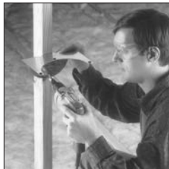
Fixer le support de montage (NB)
